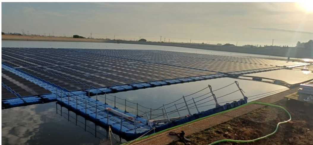
Figura 4. Estación fotovoltaica flotante balsa de Cola.
